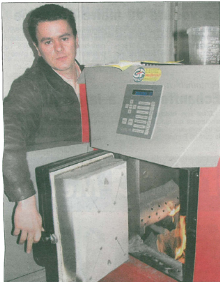
La chaudière fonctionnant avec du bois déchiqueté permet de réaliser de belles économies
